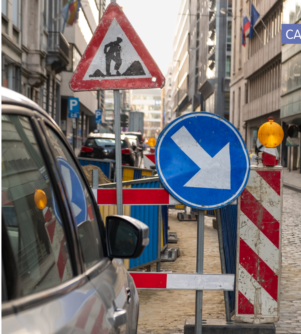
> Signalisation de travaux en voirie à charge de l'instance qui effectue les travaux
